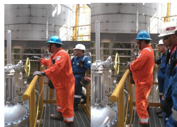
Gambar 4. Pengoperasian valve secara manual dan menggunakan aktuator berbasis impact drill
